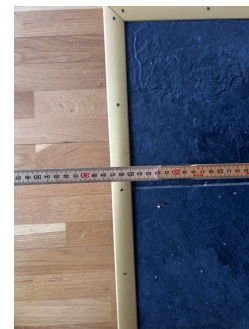
• Det er mindre enn 30cm fra ilegget fram til brennbart gulv.
