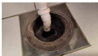
Tettesjiktets tilslutning til sluk - Sluk vaskerom
