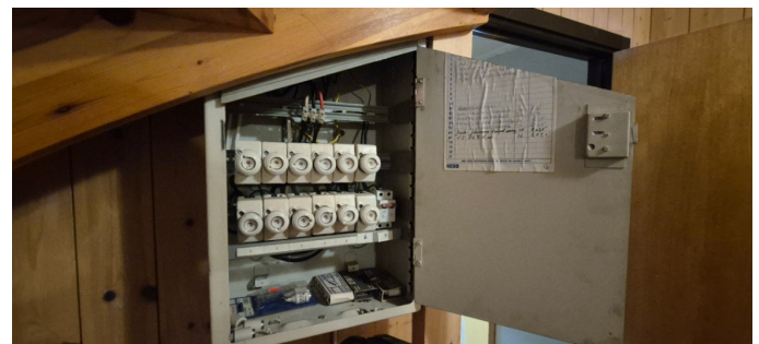
Sikringsskap i kjellerstue
