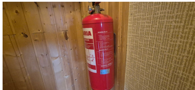
Brannslukningsapparat i 1. etasje fra 1991
