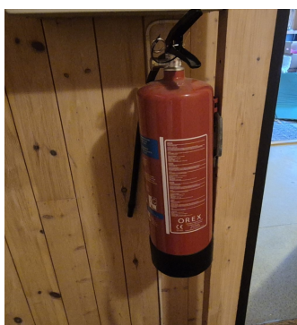
Brannslukningsapparat i kjellerstue med ukjent alder
