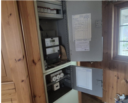
Sikringskap i vaskerom
