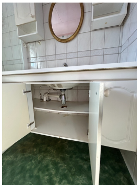
Baderomsinnredning, hylle i underskap er tydelig utsatt for fuktighet.
