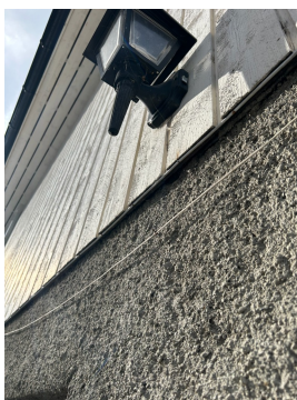
Det er ikke registrert lufting av den utvendige kledningen.
