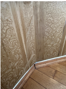
Tapet på vegg løsner og bobler seg.
