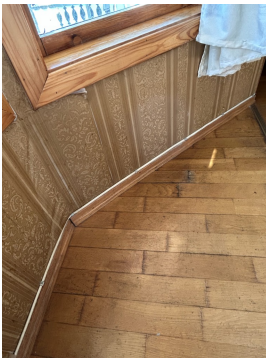
Fuktmerker på parketten i karnapp. Kontaktpersonen opplyser at dette kan ha forekommet etter mye vannsøl under vanning av blomster.
