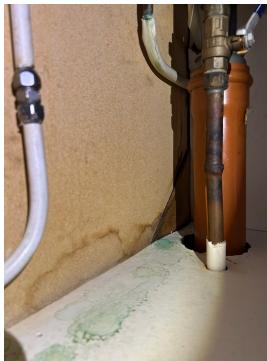
Fuktskjolder på bakveggen. Svelling av bunnplate.
