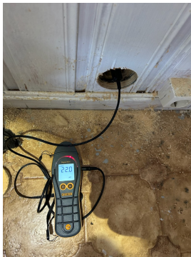
Fuktmåling i bunnsvill i det nordvestlige hjørnet i boligen.
