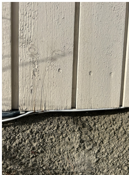
Utvendig kledning oppsprukket i nedkant.
