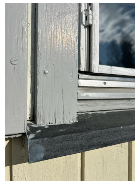
Vindusomramning med fuktskader.
