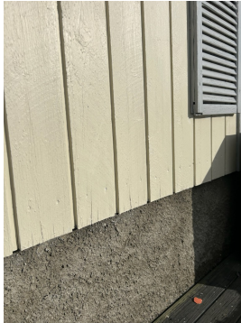
Utvendig kledning oppsprukket i nedkant.
