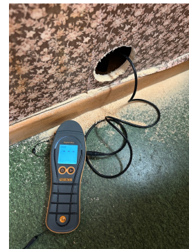
Fuktmåling i tilstøtende vegg uten å påvise unormale forhold.
