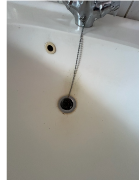
Servant fremstår med sprekkdannelser.
