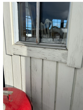
Værslitt og oppsprukket vindusomramning.
