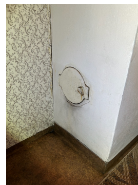
Sotluke på bad i hybel. Brennbart materiale nærmere enn 30cm fra sot/feieluke.
