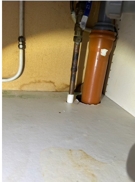
Fuktskjolder på bakveggen. Svelling av bunnplate.
