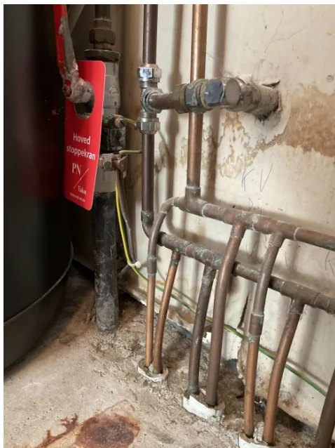
Hovedstoppekran med synlig merking
