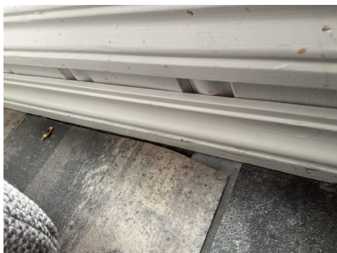
Enkelte glipper mellom gulv og fotlist/karmfliser
