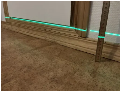
Målt avvik på 23 mm i trappegang 2.etasje.
