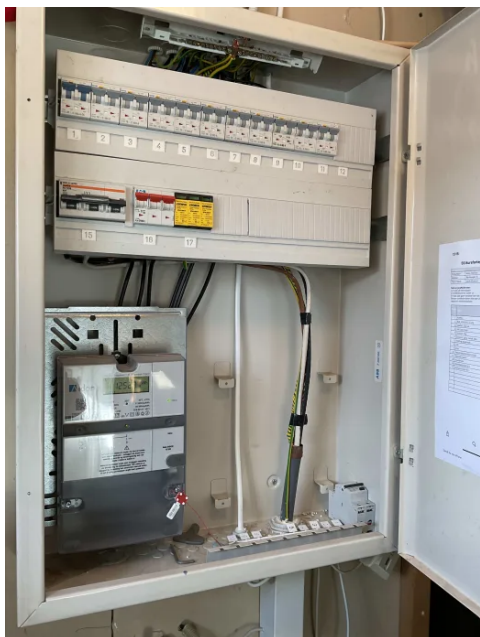
Sikringsskap plassert inne på teknisk rom/innvendig bod
