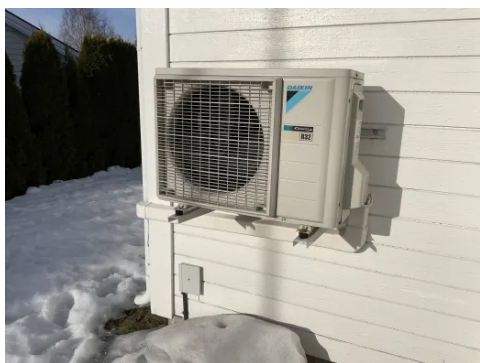
Luft/luft varmepumpe påvist fra 2018
