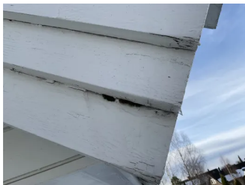
Vindskier og isbord med slitte overflater
