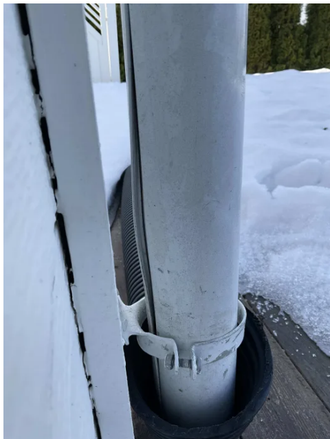
Nedløp med frostspreng
