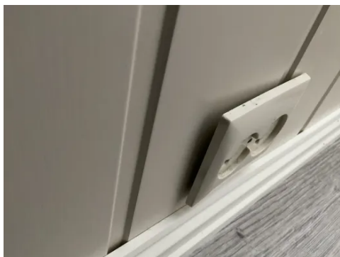
Det registrets noe løs innfesting på elektrisk utstyr
