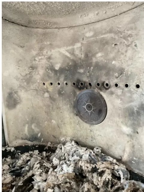
Riss/sprekk på ildstein i brennkammer
