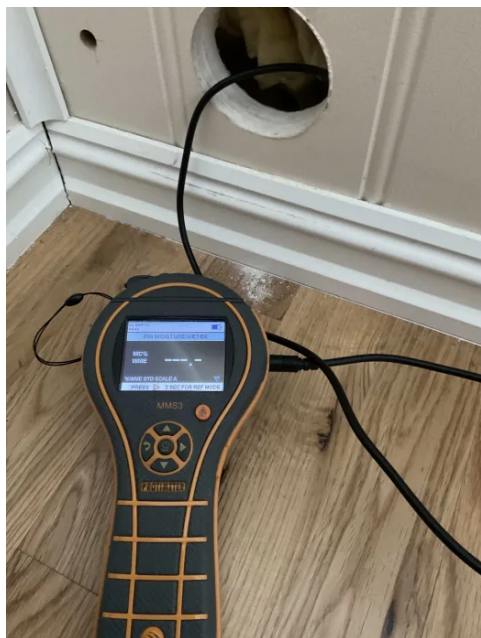
Ingen unormale verdier ved fuktøk med hulltakning
