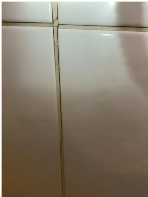
Støpte fuger med riss/oppsprekking
