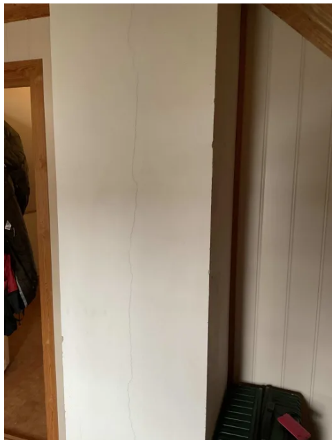
Vanger 2.etasje påvist med riss/sprekk
