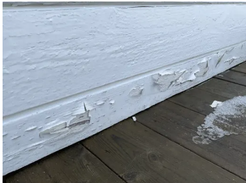
Det registreres noe malingavflassing og slitte overflater
