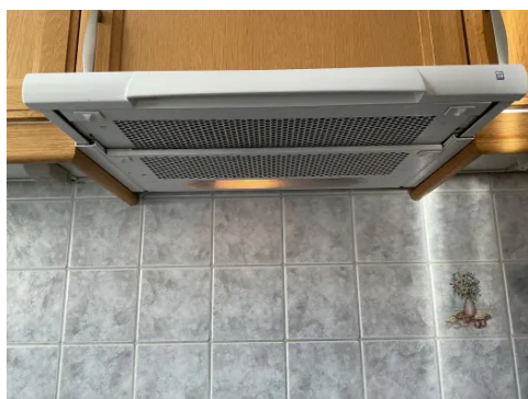
Mekanisk avtrekk over koketopp
