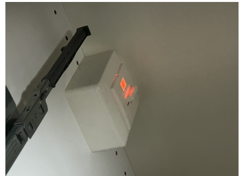
Tilkobling av varmtvannsbereder.
