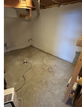
Kjellerrom mot vest, langs vegggen her siver det inn vann ved store nedbørsmengder.
