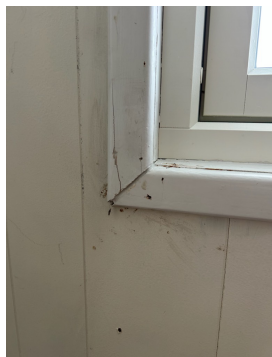
Ufagmessig utførelse av innvendig belistning.
