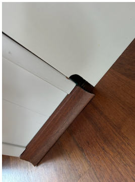
Løs gulvlist, mangler tilslutning mot skap.
