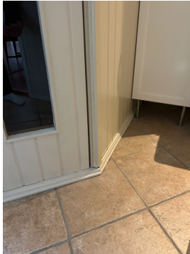
Uegnede materialer mot gulv i våtrom.
