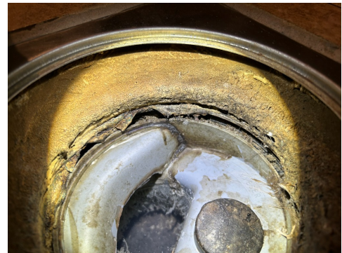
Synlig membran i sluk.
