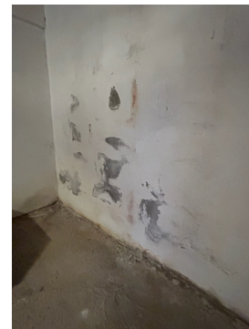
Saltutslag på vegg, maling flasser.
