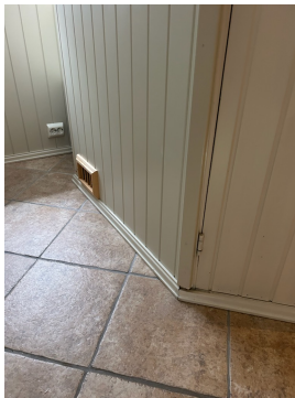
Uegnede materialer mot gulv i våtrom.
