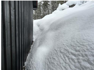
Terrengfall fra grunnmur - Fall mot bygningen
