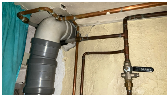
Eldre vannrør i metall.
