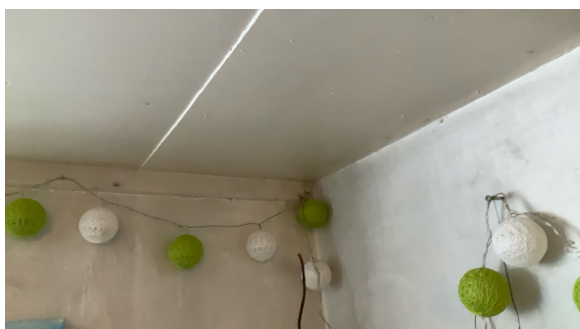
• Heksesot/støvkondens på overflater.
