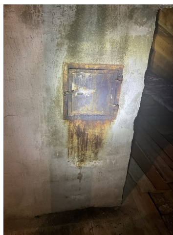
Foto 13: Sotluke i pipe med kraftig rust og avrenning
