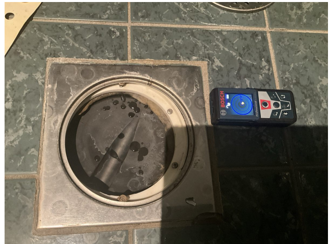
Foto 21: Hjelpesluk i dusjsone
