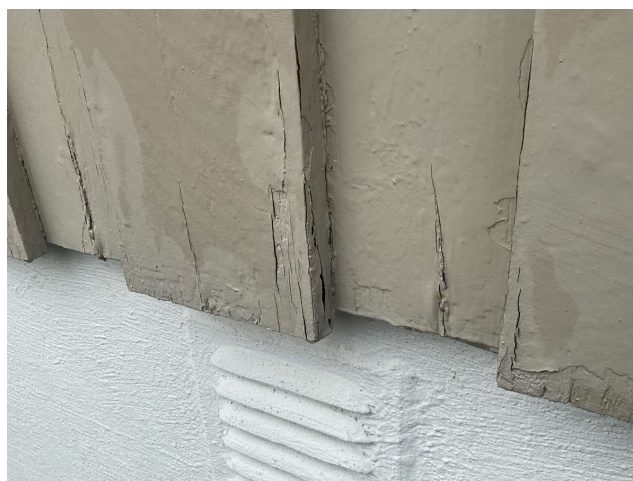
Foto 5: Råteskader i enkelte bord
