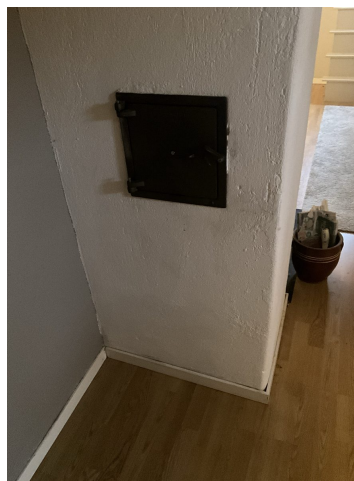
Foto 30: Sotluke mangler dekke av ildfast materiale på gulv
