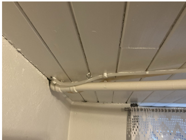
Foto 33: 32mm avløpsrør i kjellerhimling uten korrekt feste til panel
