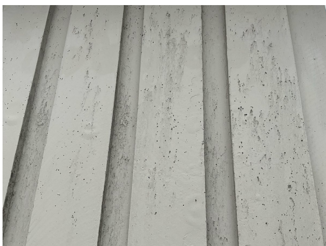
Foto 6: Kledning har generelt mye svertesopp - påregn vask og overflatebehandling
