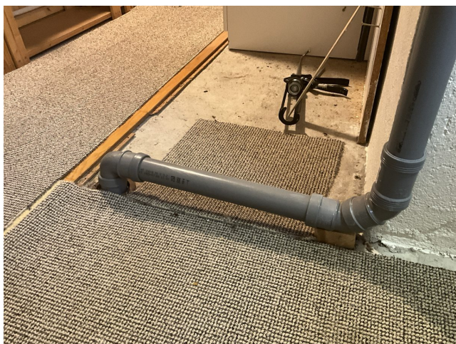
Foto 34: Ufagmessig montert avløpsrør i kjeller
