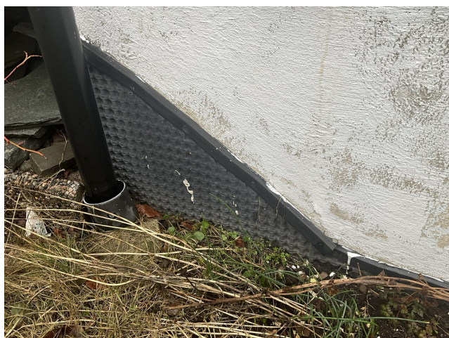
Foto 1: Dreneringsplate mot grunnmur med vegetasjon inntil
