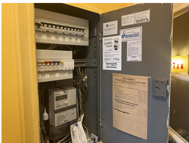
Foto 39: Sikringsskap med automatsikringer og strømmåler
