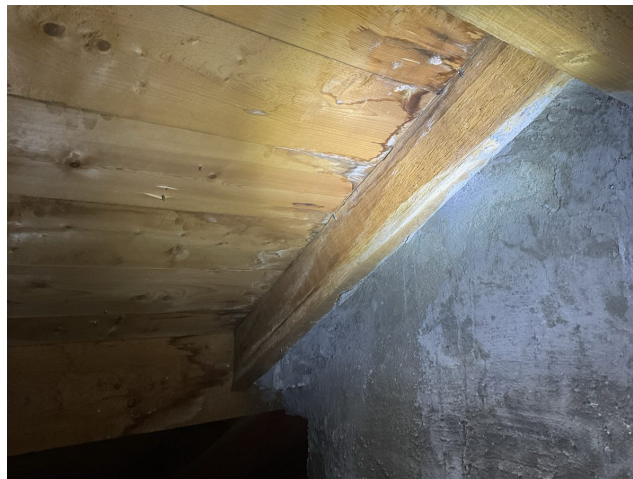
Foto 11: Takkonstruksjon med fuktskader og misfarging i tre rundt pipe
