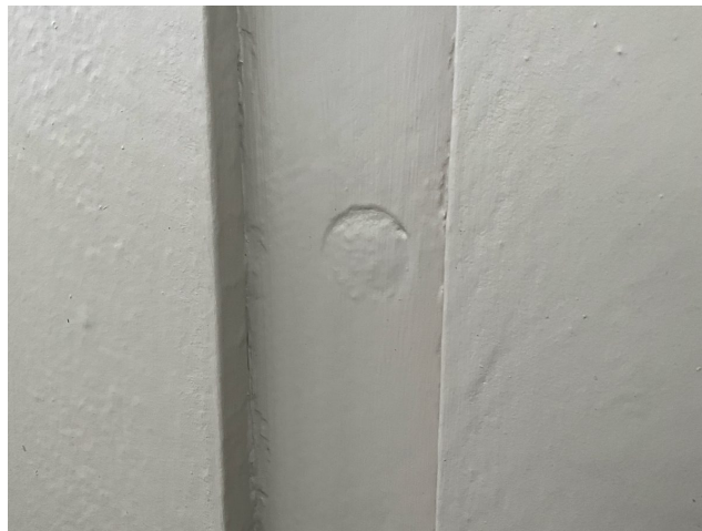
Foto 3: Synlig plugging i kledning kan tilsa at isolasjon er innblåst i yttervegger.
