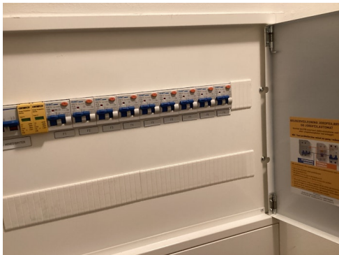
Bilde av sikringskap
