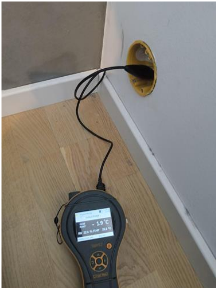
Fukt i tilliggende konstruksjoner - [Fuktmåling bad]
