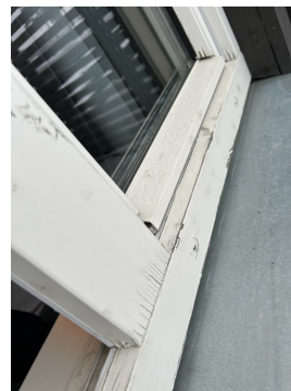
Karm er værslitt utvendig, vedlikehold må påregnes.
