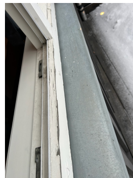
Karm er værslitt utvendig, vedlikehold må påregnes.
