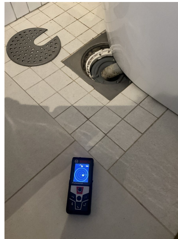
Foto 7: Fallforhold ved sluk
