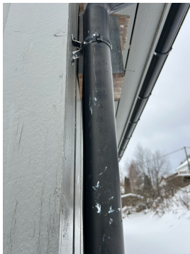
Deformasjon etter frostsprenging.
