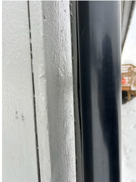
Deformasjon etter frostsprenging.
