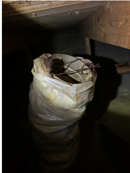
Avtrekkskanal avsluttet på loft.
