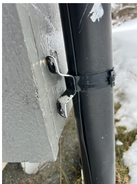
Nedløpsklammer som ikke er festet.
