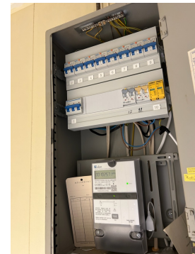
Sikringskap med automatsikringer.
