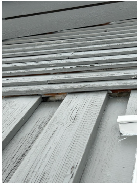
Åpning inn i isolasjonen i overgang stående / liggende kledning.
