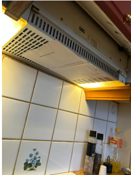
Avtrekksvifte fungerer som tiltenkt på befaringsdagen.
