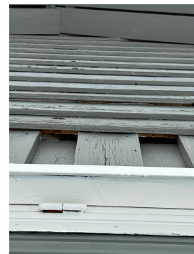
Åpning inn i isolasjonen i overgang stående / liggende kledning.
