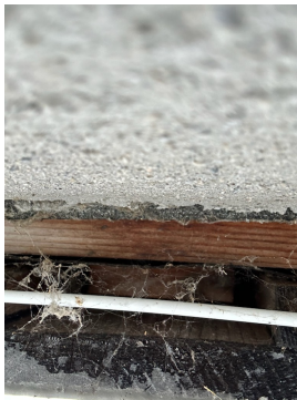
Ingen lufting bak bordkledningen.
