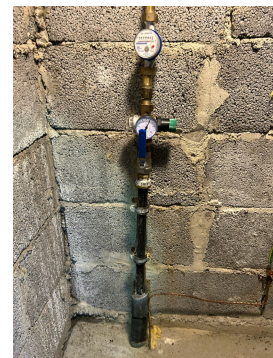
Vanninntak med stoppekran og vannmåler.
