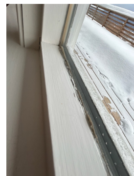
Tydelige behov for utbedring/utskifting.
