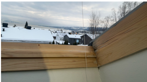
Fuktmerker på takvindu, takvinduer har økt risiko for fuktskader.
