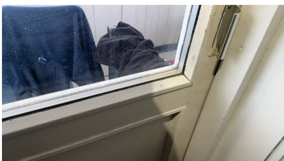
Tegn på punktert isolerglass.
