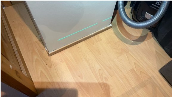
Gulv er lagt inntil pipevange.
