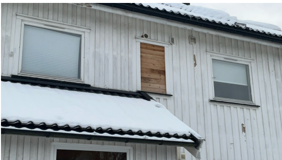
Provisorisk tetting av vindusåpning, øker risikoen for fuktinntregning.
