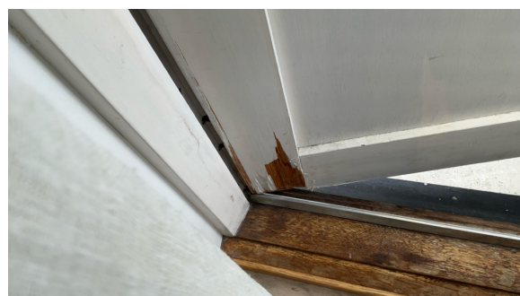
Skade på verandadør 1. etasje.
