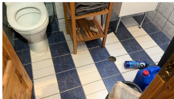
Ved eventuell vannlekkasje vil vann renne ut av våtrommet og øker risikoen for omfattende fuktskader.
