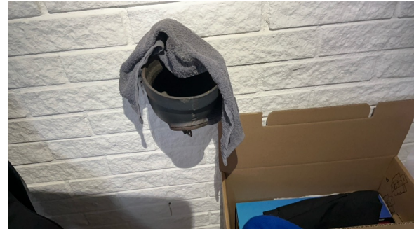
Røykrør er ikke tilstrekkelig tettet etter fjerning av ildsted. Dette er også bemerket fra brannforebyggende.
