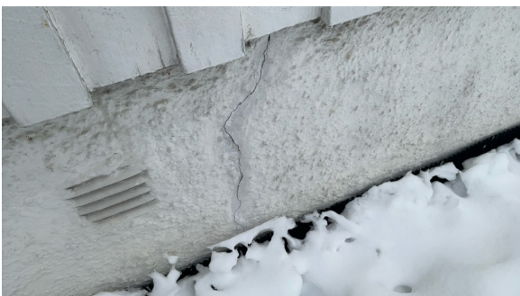
Sprekker i grunnmur.
