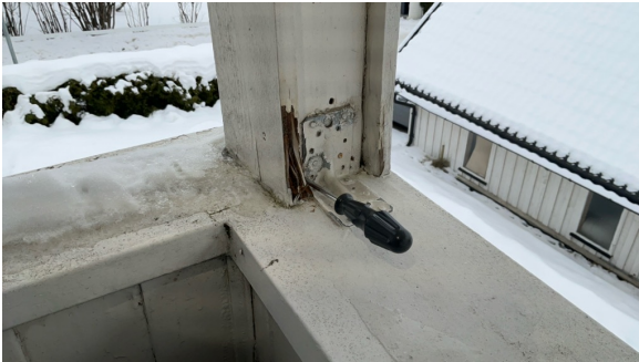
Råteskader i søyle som understøtter takoverbygg.
