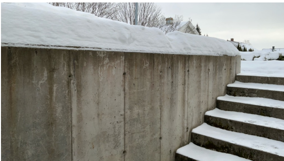
Manglende rekkverk på støttemur.
