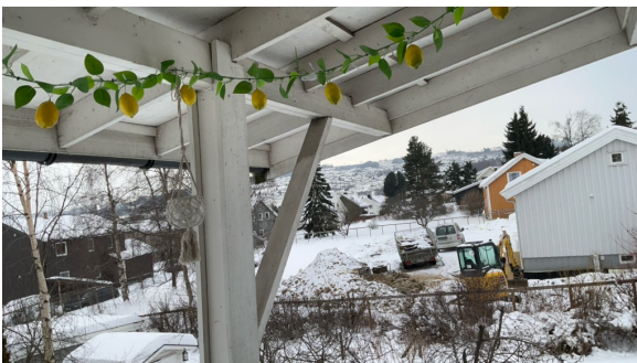
Lang utkraging av takoverbygg, risiko for svikt.
