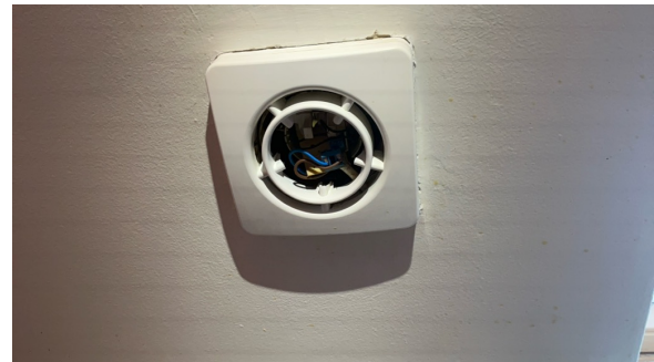
Åpen kobling på vifte loftsetasje
