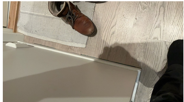
Glippe mellom gulvlist og gulvflate.
