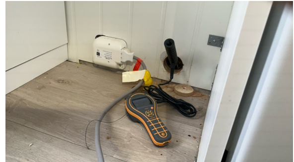
Hulltaking er utført mot våtsone siden av dusj. Fuktmåling viste tørre verdier. Antall platelag og bakenforliggende rør begrenset inspeksjonen.
