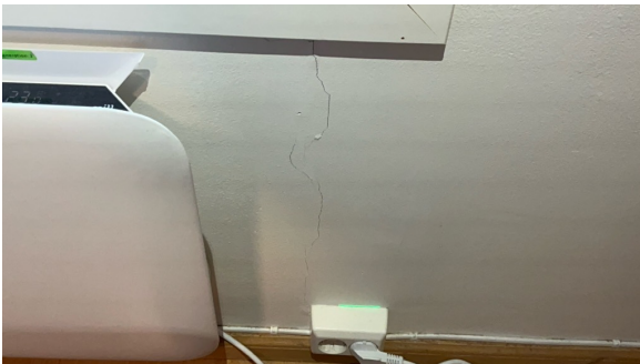
Sprekker i overflater flere steder.
