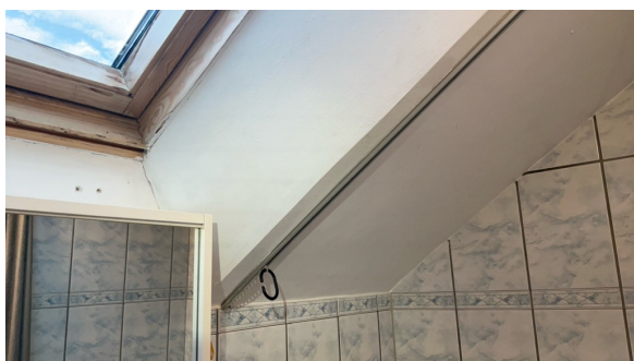
Skråhimling er sannsynligvis ikke utført med våtromssystem.
