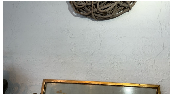
Riss i pipe.
