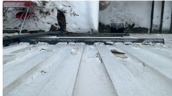
Flasing av maling flere steder, kledning bærer preg av slitasje.
