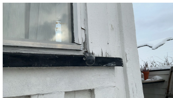
Råteskadde vinduer registrert.
