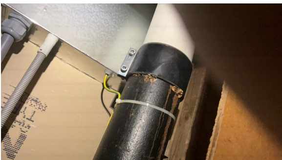
Rust på eldre metallrør.
