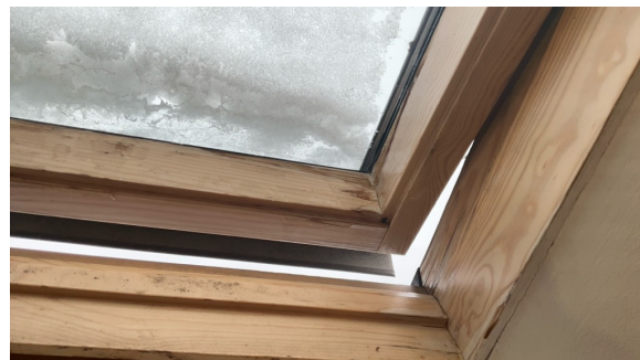
Kondensmerker på takvindu.
