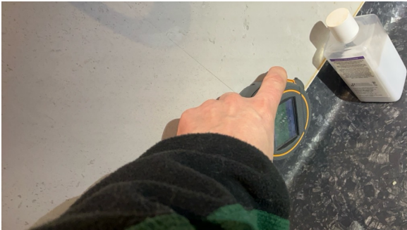
Enkle fuktsøk viste normale verdier.
