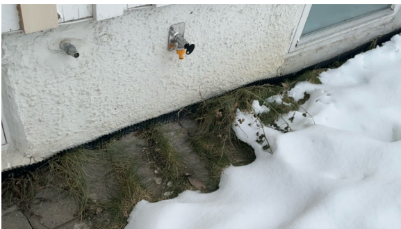
Manglende avslutningslist på grunnmursplast.
