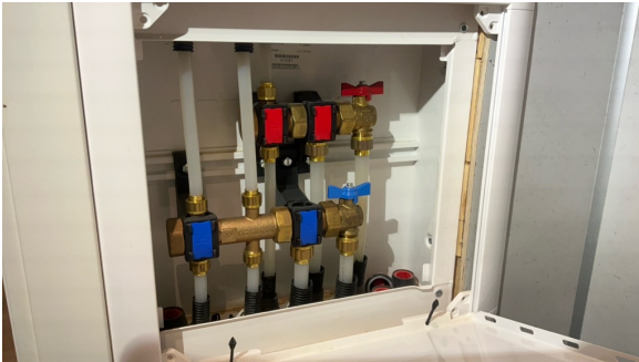
Fordelerskap bad 2. etasje.
