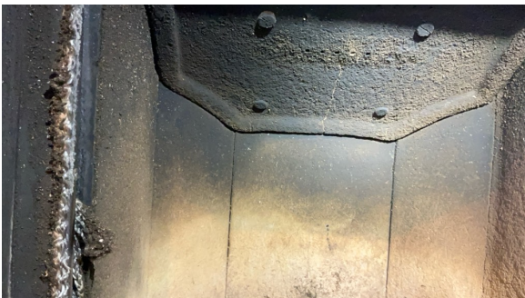
Sprekk i ildfast stein inni ildsted.
