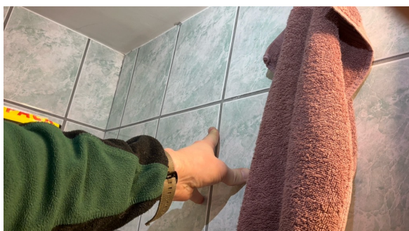
Løse fliser på vegg registrert.
