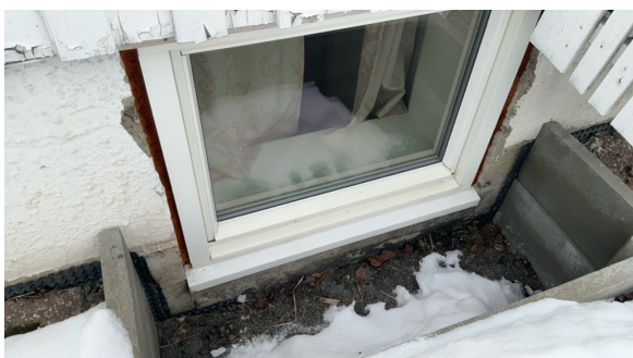
Gjenstående arbeider på enkelte vinduer, manglende omramming øker risikoen for fuktinntregning og kan redusere levetiden på bygningsdelen.
