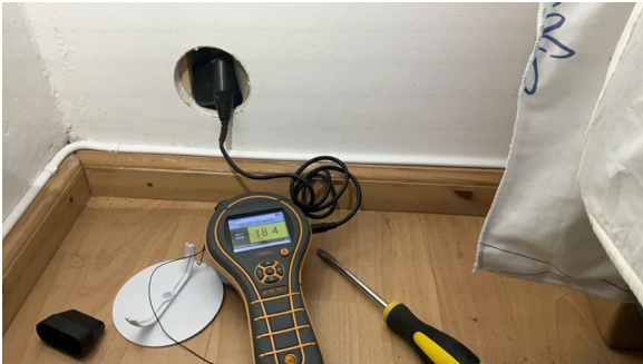
Hulltaking er foretatt, fuktmåling viste skadelige og risikable verdier for fukt.
