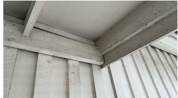
Takoverbygg har sannsynligvis ikke tilstrekkelig bæreevne. Kantbjelke er festet utenpå kledning.
