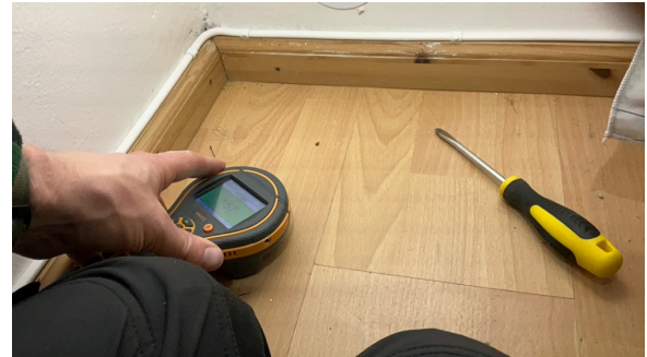
Svelling på gulvflater. Fuktsøk viste normale verdier. Det er usikkert om årsaken er fukt fra grunnen eller vannsøl/vask.
