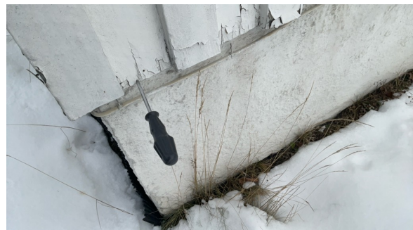
Enkelte råteskader registrert på utvendig kledning.
