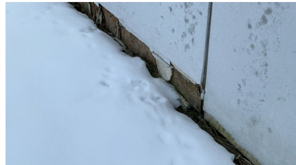
Trefiberplater under veranda har svelleskader, materialet anses som uegnet til utebruk. Dør under veranda er ikke mulig å åpne grunnet snø og is, undersiden er derfor ikke inspisert.
