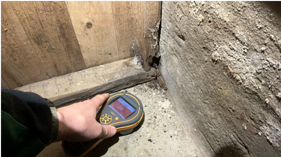
Råteskadet treverk i kjeller. Enkle fuktsøk viste forhøyde verdier.
