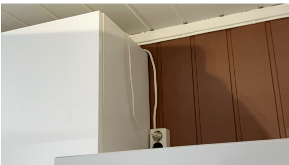
Løs ledning 1. etasje kjøkken.
