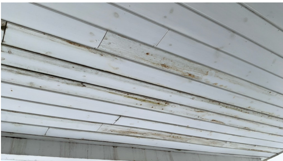
Fuktmerker under veranda 2. etasje. Sannsynligvis utett tekking.
