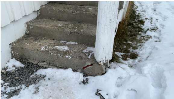
Fundament/betongtrapp til overstående veranda/altan har større sprekkdannelser og fremstår sviktende.
