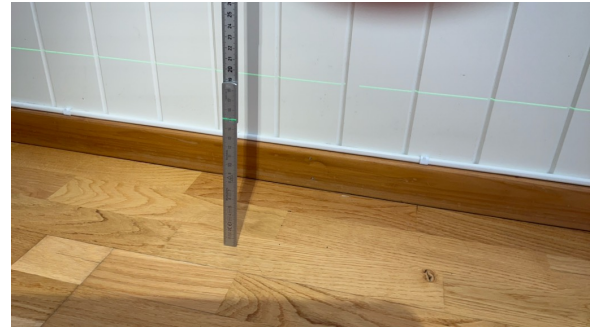
Total helningsavvik på ca. 48 mm i stue 2. etasje.
