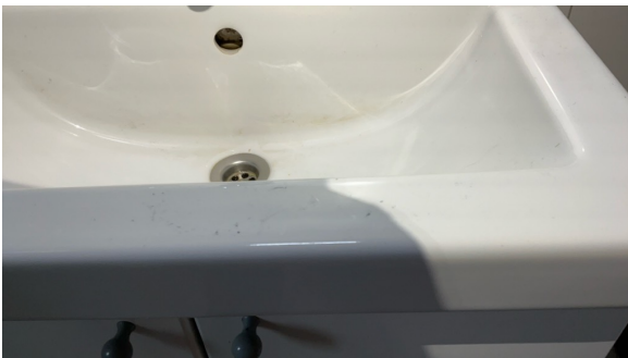
Dårlig avrenning i servant bad 1. etasje.
