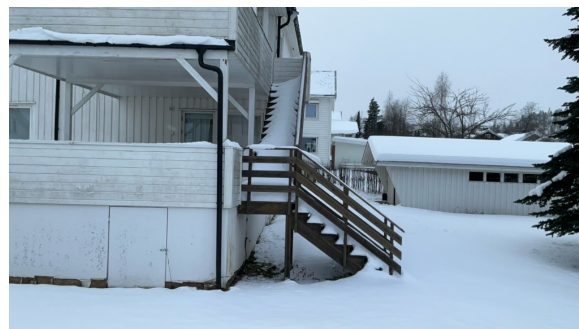
Manglende rekkverk i tretrapper.
