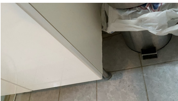
Svelleskader på innredning.
