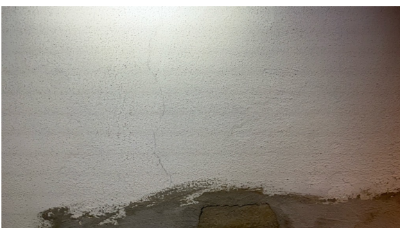
Riss i pipe.
