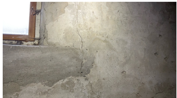
Sprekker i grunnmur enkelte steder.
