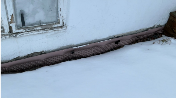
Manglende avslutningslist over grunnmursplast.
