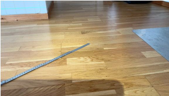
Helningsavvik på ca. 25 mm over en avstand innen 2 meter i 2. etasje.
