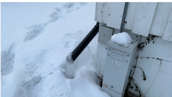
Takvann ledes ikke bort fra bygningen.
