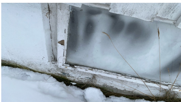
Kjellervinduer bærer preg av slitasje og har råteskader.
