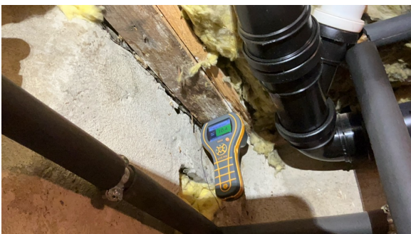
Misfarging på etasjeskille kjeller. Fuktmåling viste tørre verdier.
