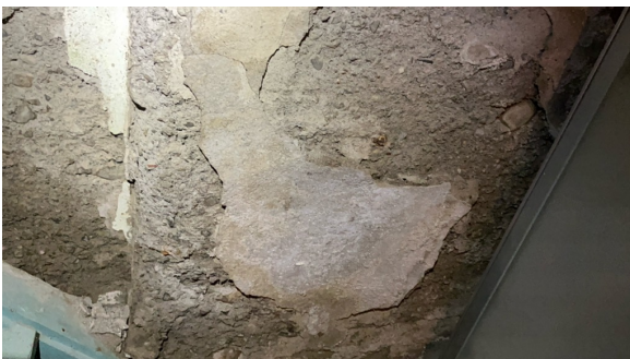
Grunnmur forvitrer enkelte steder, dette indikerer dårlig betongkvalitet.
