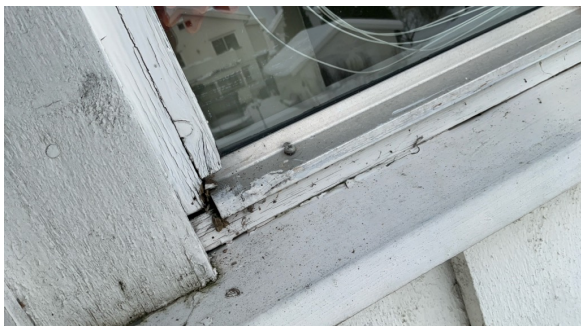
Råteskadet vindu registrert.
