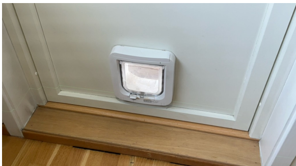
Katteluke i dør, dette kan svekke døren med tanke på isolasjonsevne.
