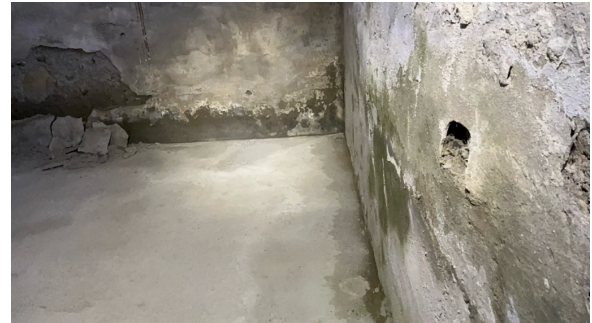
Saltutslag, avskalling og synlig fukt i kjeller.
