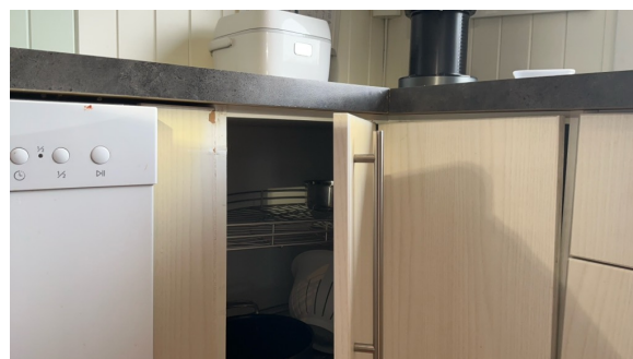
Skapdør er løs.
