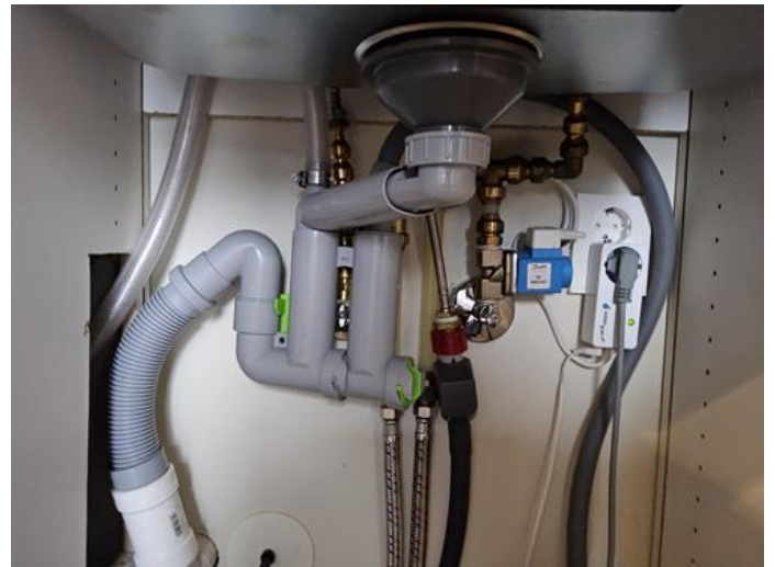
Kjøkken - [Rørplegg i kjøkkenbenk]
