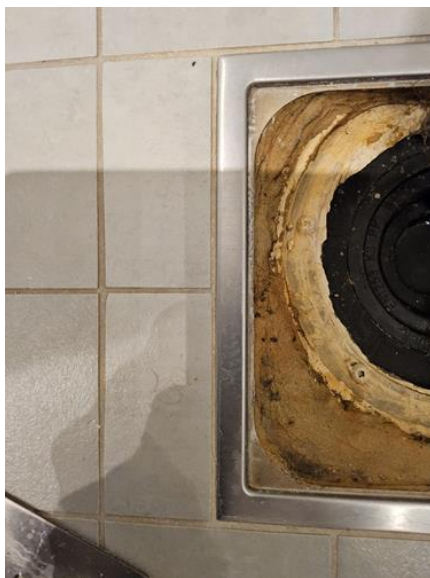
Våtrom - [Det er benyttet sluk mansjett]
