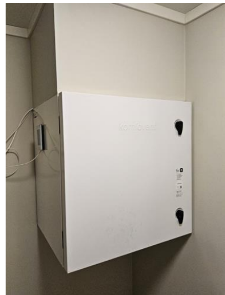
Tekniske anlegg, VVS anlegg (Sjekkpunkter utover det som er inkludert i andre rom) - [Ventilasjonsaggregat]
