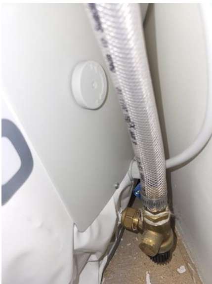
Tekniske anlegg, VVS anlegg (Sjekkpunkter utover det som er inkludert i andre rom) - [Sikkerhetsventil VVB]
