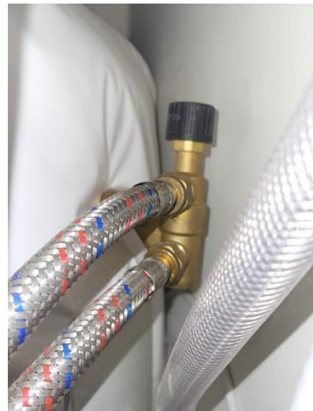
Tekniske anlegg, VVS anlegg (Sjekkpunkter utover det som er inkludert i andre rom) - [Tilkobling VVB]
