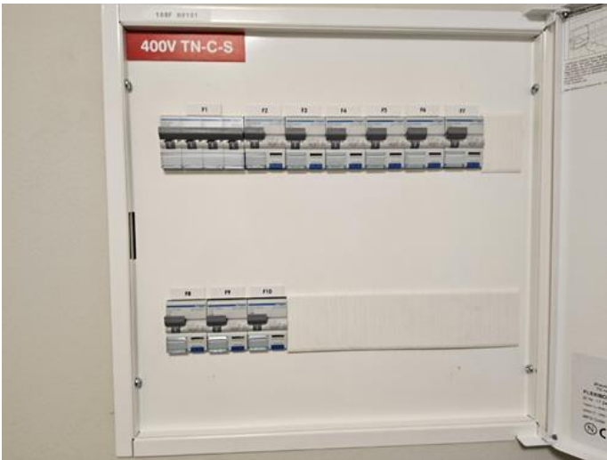
Elektrisk anlegg - [Sikringskap]
