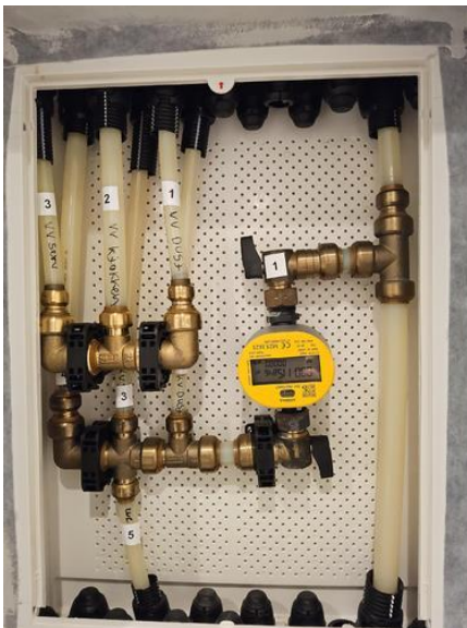
Tekniske anlegg, VVS anlegg (Sjekkpunkter utover det som er inkludert i andre rom) - [Koblingskap for vann og stoppekran]
