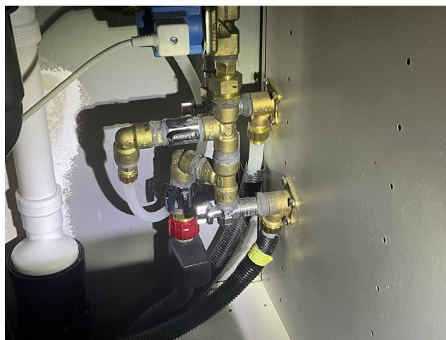
Foto 20: Rørføring med ventiler og koblinger under kjøkken.
