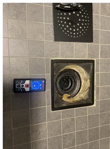
Foto 7: Gulvsluk og maling av fall mot sluk
