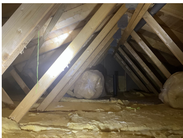
Foto 4: Loftstrom med isolasjon.
