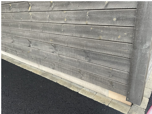
Foto 2: Trekledning med grånet overflate ved grunnmur
