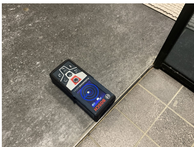
Foto 8: Fallforhold utenfor dusjnisse/nedsenket gulv
