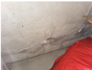
Overflate vegg - Eksempel på fuktmerker i kjellervegg.
