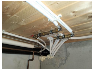
Fordelerskap og fordelerstammer - Fordelerstammer for rør-i-rør.
