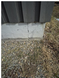
Grunnmur og fundament - Eksempel på sprekkdannelse i grunnmur.
