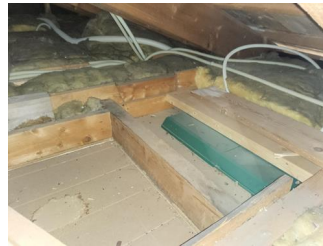
Annet - Manglende isolasjon over downlightskasse.
