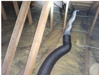
Kondensisolerings av rør og ventilasjonskanaler - Eksempel på uisolerte ventilasjonsrør på loft.
