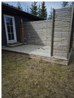
Tilstand på rekkverk og overflatematerialer - Terrasse.
