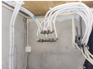
Fordelerskap og fordelerstammer - Fordelerstammer for rør-i-rør.
