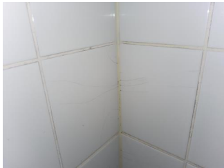
Overflater vegger - Riss i fliser i dusjsonen.
