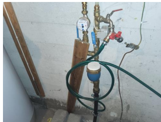
Innvendig stoppekran - Innvendig stoppekran, vannmåler og vannstopper.
