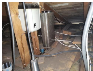
Ildsteder - Dagtank/oljeløfter i forbindelse med tidligere opplegg for parafinbrenner plassert på loft.
