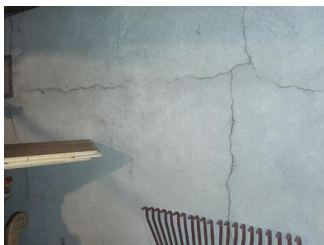
Overflate vegg - Eksempel på riss/sprekker i vegger.
