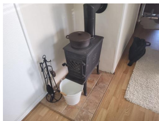
Ildsteder - Ildsted underetasje.
