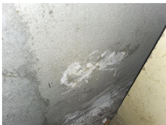
Overflate vegg - Eksempel på fuktmerker på vegg.
