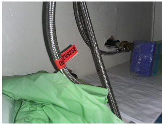
Vannrør - Vannrør uten tetting mellom varerør og vannrør.
