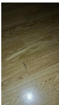
Overflate gulv - Skade på kjøkkengulv
