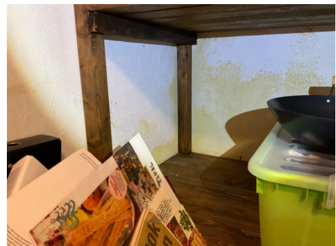
Flekker på innvendig maling av grunnmur
