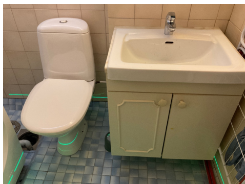
Servant i innredning og toalett
