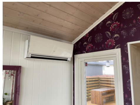
Varmepumpe montert i stuen
