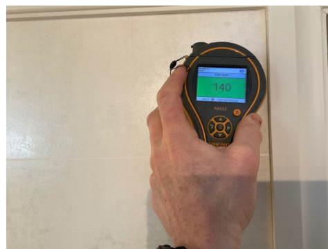
Fuktmåling oppe ved dør
