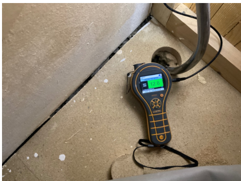
Hulltaking i oppforet kjellergulv i rom under terreng 25. mars 2026
