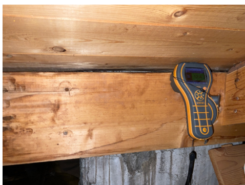
Fuktmåling ved pipen i boligen
