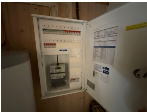
Sikringsskap i boden
