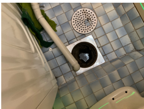
Sluk på vaskerom
