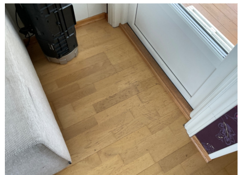
Bruksslitasje ved terrassedøren
