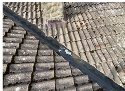
Avflassing av beslag og manglende takstein i gradrenne.
