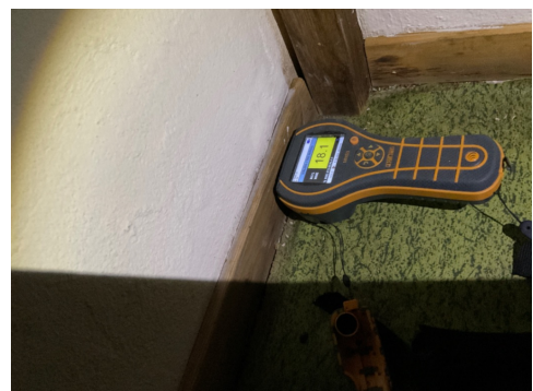
Fuktmåling i gulvlist i bod
