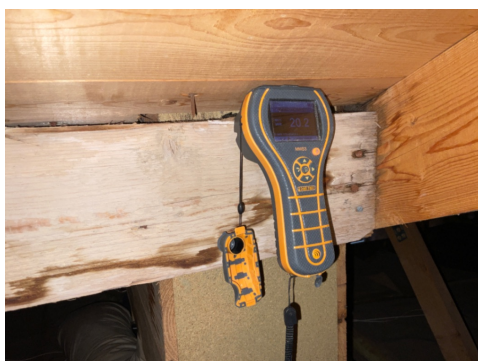
Fuktmåling ved luftepipe i boligen 20,2 vekt %
