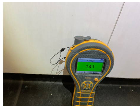
Fuktmåling i bunnen av baderomsplater i dusjnisen. @
