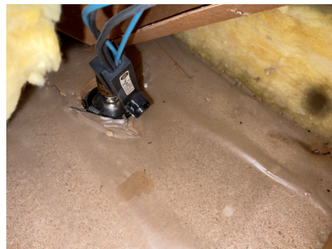
Brutt dampsperre på loft, downlights fra kjøkken
