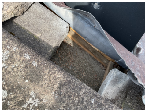
Manglende oppkant på luftpipe
