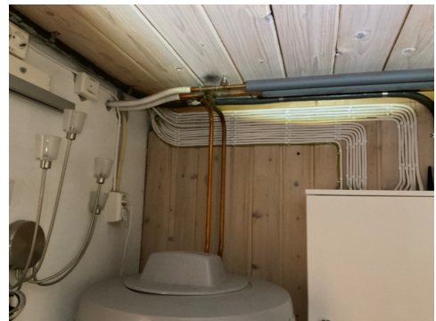
Kobberør synlig over bereder
