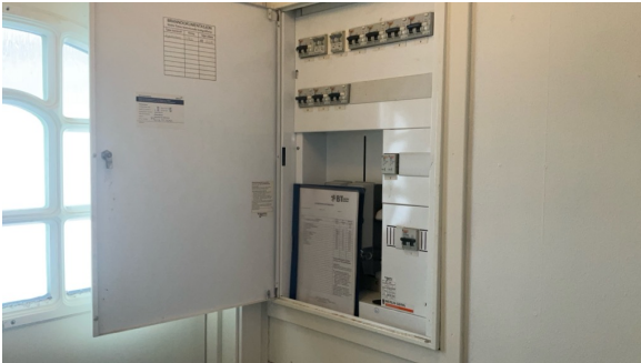
Sikringskap med automatsikringer er plassert i entre i 1.etasje.
