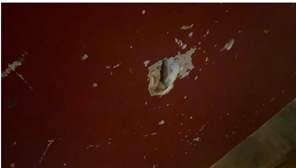
Eksempler på skader på overflater.
