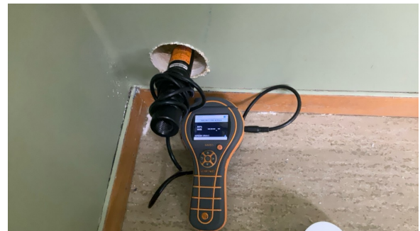
Fuktmåling med pigg mot våtrom: Det ble ikke målt forhøyde fuktverdier ved hulltaking på befaringstidspunktet.
