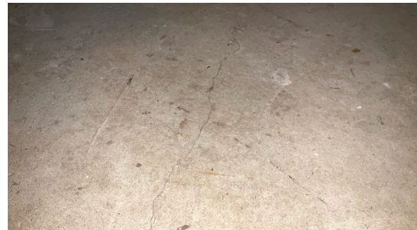
Det er registrert sprekker i betonggulv i kjeller.
