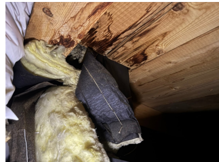
Det er registrert fuktmerker på undertak rundt gjennomføring.
