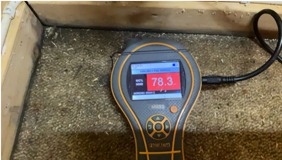
Det er utført fuktmåling som indikerer forhøyede fuktverdier i innebygde konstruksjoner.
