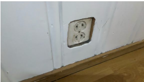
Stikkontakt er delvis innbygd i vegg - dette er ikke forskriftsmessig utført.
