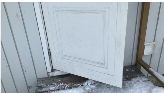
Dører er værslitte utvendig og det er sprekker i overflate. Løs tettelist på dørbblad
