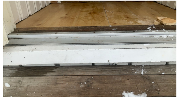
Løst beslag under ytterdør.
