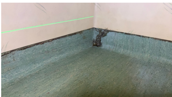
Missfarget og skade overflater i våtsone.
