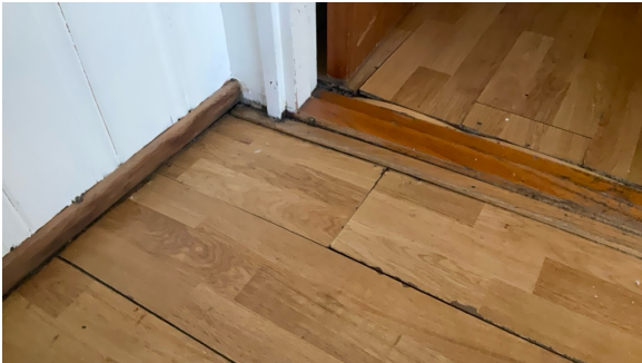
Eksempler på skader på overflater.
