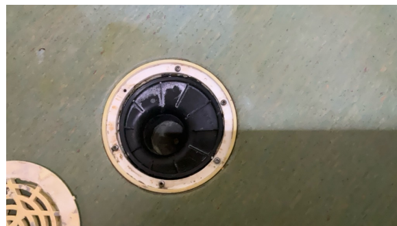
Eldre plastsluk med klemring for gulvbelegg.
