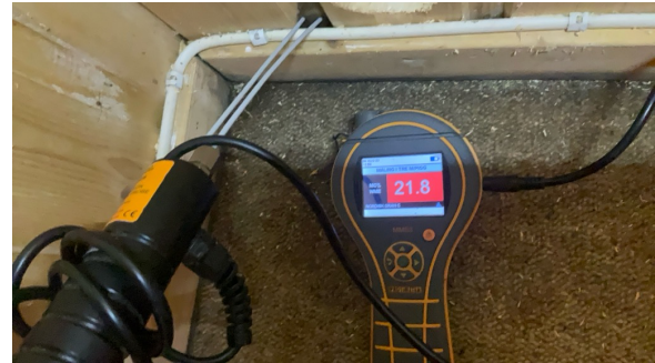
Det er påvist forhøyede fuktverdier i trepanel i kjellerstue.
