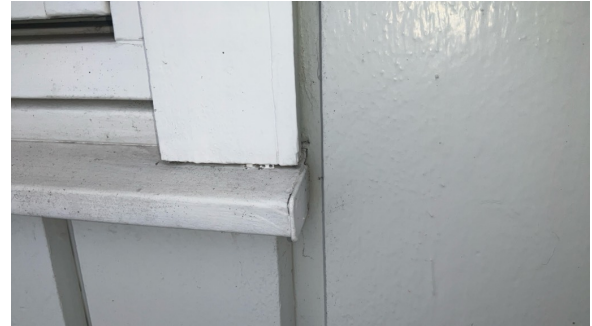
Ingen eller liten avstand fra kledning og ned på vannbrett/beslag.
