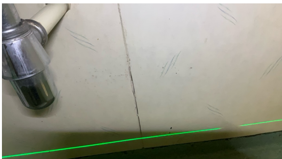
Sprekker i våtromsbelegg i våtsone. Det vil si utettheter som kan føre til skader i tilliggende konstruksjoner.
