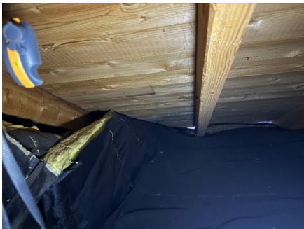
Isolasjon dekker delvis lufting mot raft/takfot.
