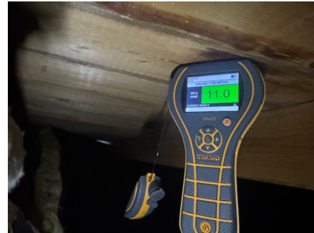
Det er usikkert om fuktmerker skyldes eldre eller nyere vanngjennomtrengning. Merker var tørre på befaringdagen.
