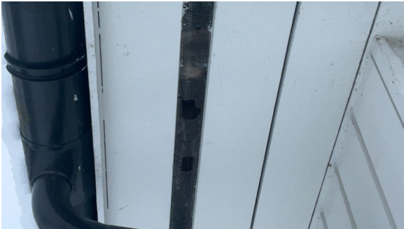
Hull/skader i insektsnett på luftespalter.
