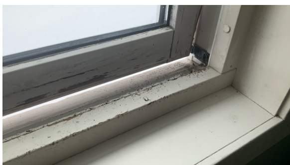
Stor bruksslitasje på enkelte vinduer. Ødelagte tettelister.
