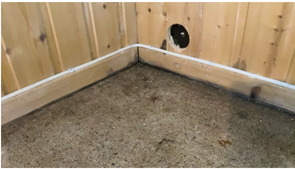
Synlige fuktskader på overflater i kjellerstue.
