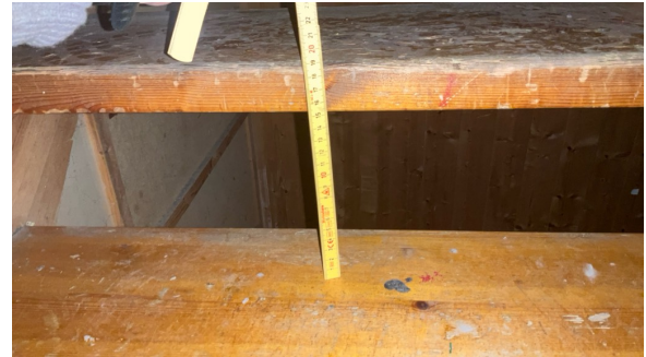
Åpninger mellom trinn i innvendig trapp er større enn dagens forskriftskrav som er maks 10 cm.
