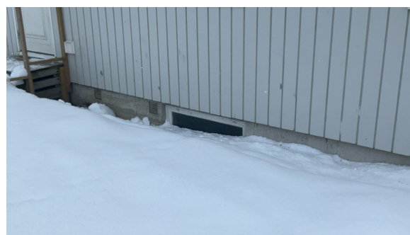
Lav høyde mellom terreng og kjellervinduer.
