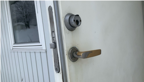
Låsekasse er ikke tilstrekkelig festet.
