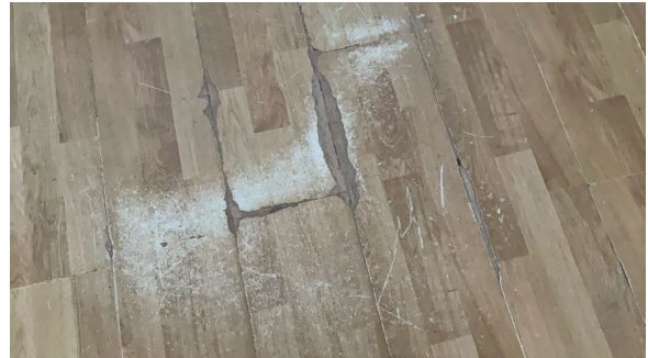
Eksempler på skader på overflater.
