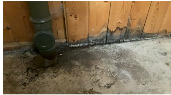
Synlige fukt/råteskader på trepanel i kjeller. Dette kan ha en sammenheng med fuktskader som er påvist på kjøkken.
