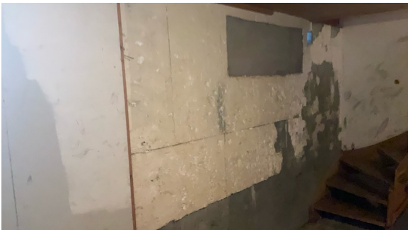
Det er synlig brennbar isolasjon på grunnmur.
