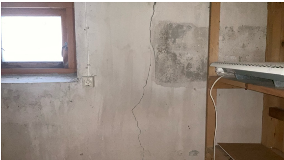
Sprekker er registrert i grunnmur.
