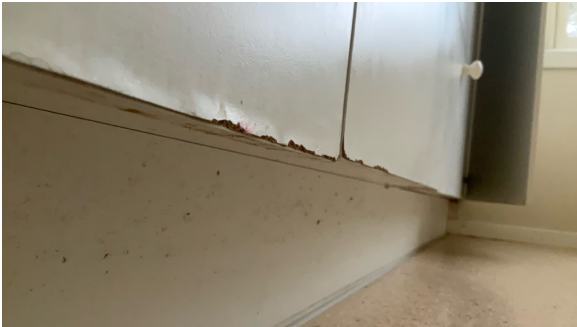
Fuktsvellinger i nedkant av enkelte fronter.
