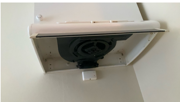
Ventilatorens funksjon er ikke kontrollert siden rist har skader.
