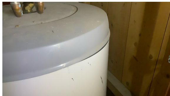
Skade på bereder.
