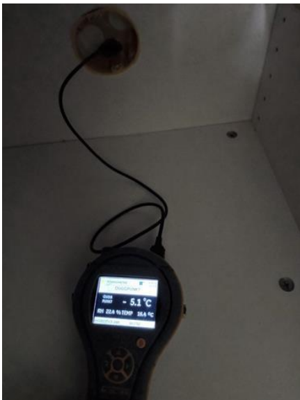
Fukt i tiliggende konstruksjoner - [Fuktmåling bad 2 etasje ]
