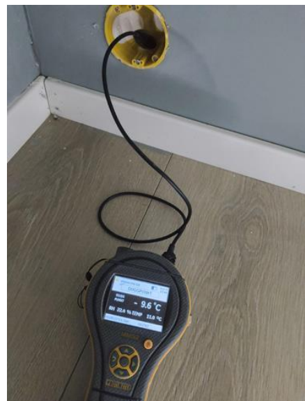
Konstruksjoner (tilfarergulv, himling og vegger). - [Fuktmåling kjellevegg ]
