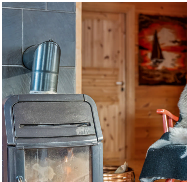
Oppvarming med vedfyring og naturlig ventilasjon
