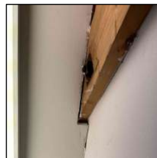
Bilde 2: Manglende tetning mellom tilslutninger.
