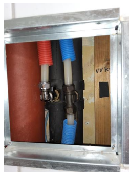
Vannrør - Hoved vann/avløp i sjakt.
