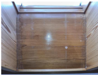
Takvinduer - Fuktmerker på innvendig foring
