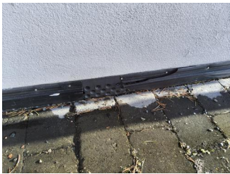
Fuktsikring av grunnmur - Skade i topplst
