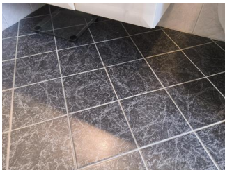
Overflater gulv - Området med løse fliser
