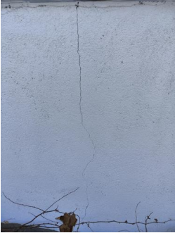
Grunnmur og fundament - Riss i grunnmur
