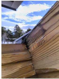
Takvinduer - Fuktmerker og muggstopp i vinduskarm
