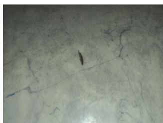
Overflater gulv - Skade i belegg
