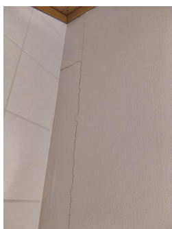
Overflater vegger - Riss/sprekk i vegg bak servant
