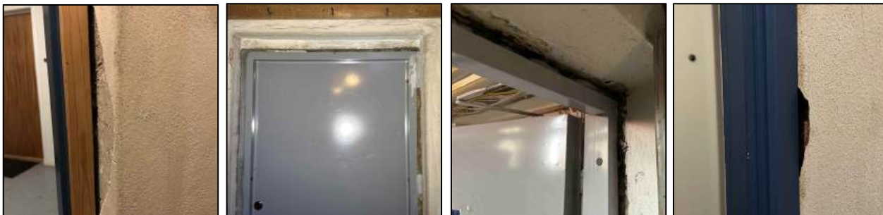
Bilde 1: Eksempler på steder det mangler, eller ikke er tilstrekkelig tetning rundt dører.
