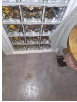
Overflater vegg - Tidligere døråpning.
