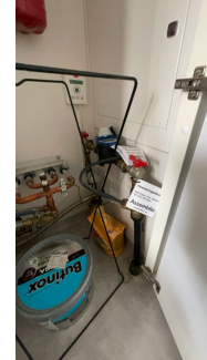
Stoppekran er plassert i vaskerom.
