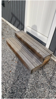
Slitasje på trapp og behov for vedlikehold.
