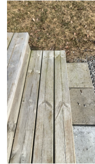
Slitasje på trapp og behov for vedlikehold.
