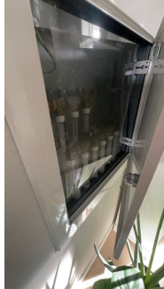
Fordelerskap for vannledninger til bad plassert i gang,.
