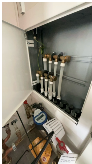
Fordelerskap plasser på vaskerom.
