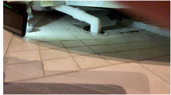
Sluk under dusjkabinett. Begrenset inspeksjon
