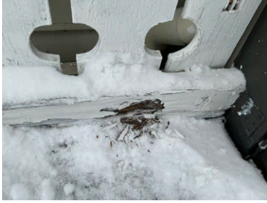
Det registreres råte i rekkeverk til balkong.
