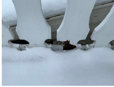
Det registreres råte i rekkeverk til balkong.
