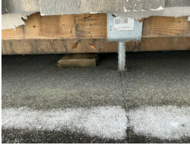
Balkong over garasje er oppført i trekonstruksjoner over mur/betongdekke. Det er lagt asfaltpapp over betongdekke hvor dette er synlig/kontrollert. Det er ikke fuget/tettet rundt søylesko som er boret ned i «tak».
