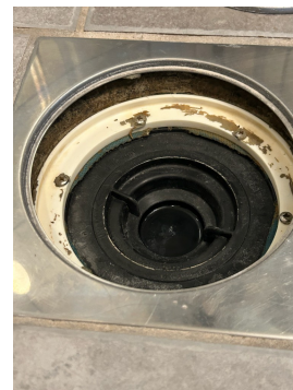
Sluk i dusjhjørnet, med synlig membran under klemring.
