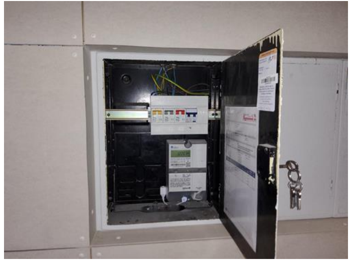
Elektrisk anlegg - [Sikringskap. ]
