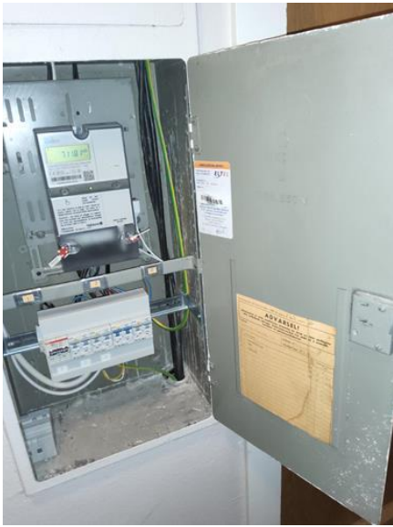
Elektrisk anlegg - [Sikringskap ]
