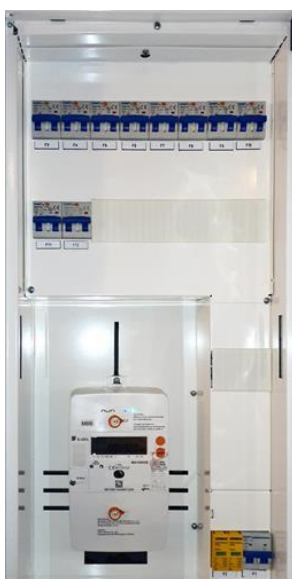
Elektrisk anlegg - [Sikringsakk]
