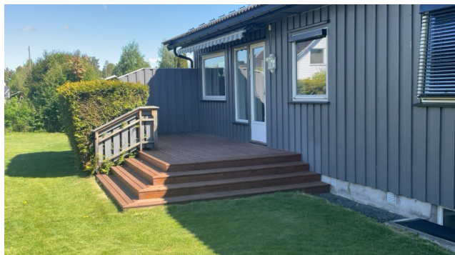
Utleidel med veranda på ca. 12 m 2 . Gulv av imprgnerte terrassebod. Rekkver med høyde på ca. 88 cm. Avstand til terreng ca. 50 cm.
