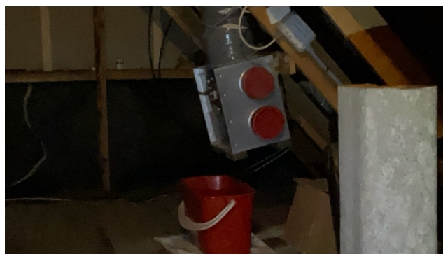
Avtreksvifte på loft.
