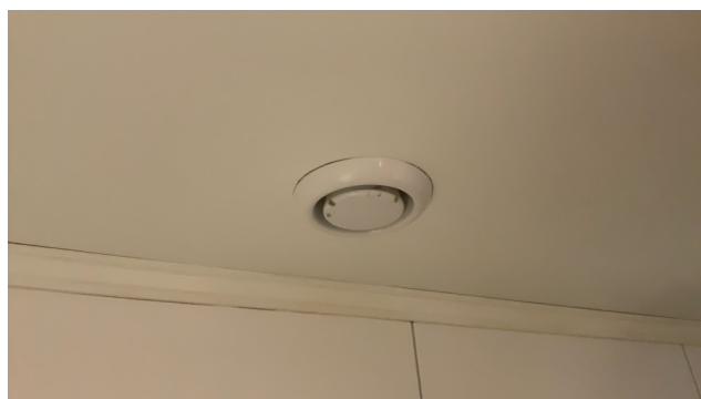
Avtreksventil i himling.
