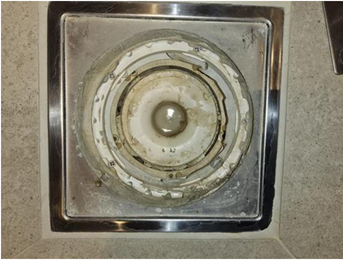
Våtrom - [Sluk bad 1.etg.]
