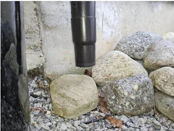
Drenering - [Takvann ledes ikke vekk fra grunnmuren. ]
