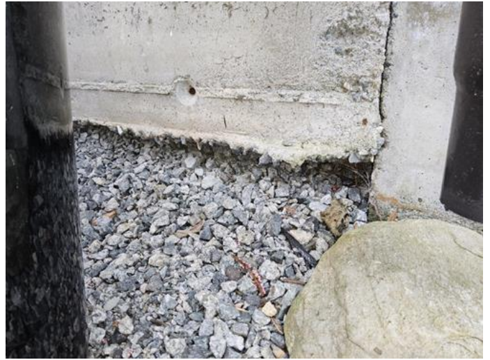
Grunnmur, fundamenter - [Utglidning av masse under påbygg. ]
