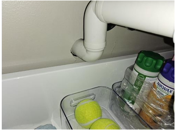
Våtrom - [Utett rørgjennomføring i våtsone under servant.]
