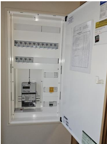
Elektrisk anlegg - [Sikringskap]
