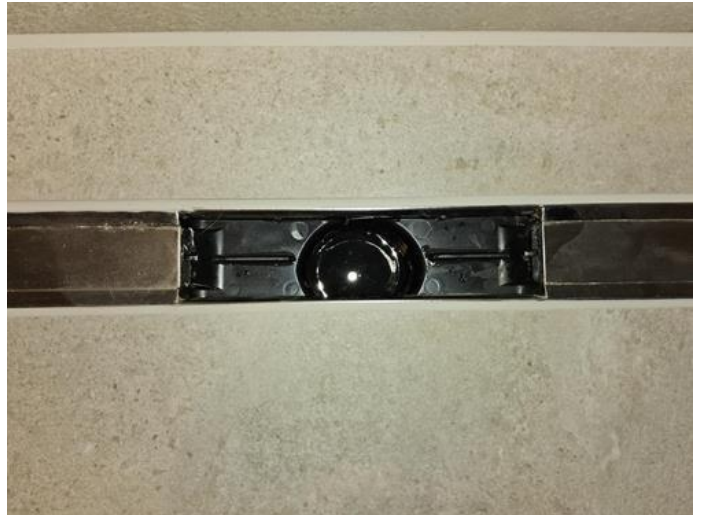
Våtrom - [Sluk bad 2.etg.]
