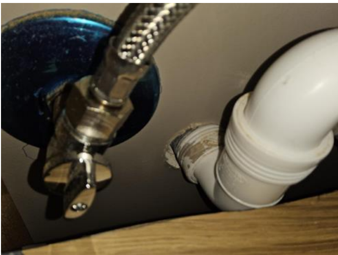
Våtrom - [Utett rørgjennomføring i våtsone under servant.]
