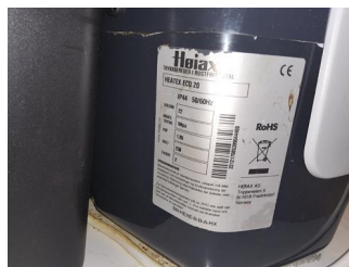
Varmtvannsbereder - Varmtvannsbereder kjøkken
