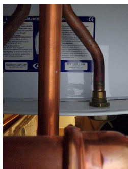
Varmtvannsbereder - Varmtvannsbereder bod
