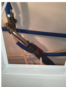
Innvendig stoppekran - Hovedstoppekran
