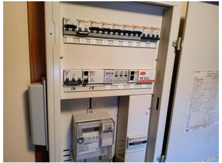
Elektrisk anlegg - [Sikringskap]
