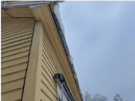
Ingen lufting i gesims
