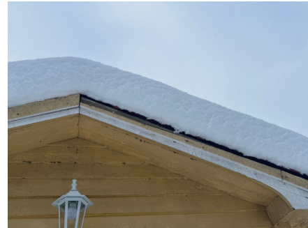
Lokalt manglende vindskiebord på inngangsparti
