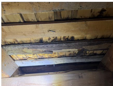
Fuktmerker i undertak
