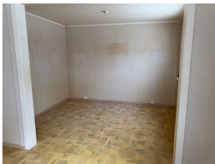
Eldre og slitte overflater
