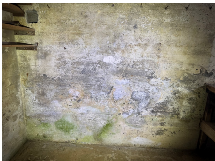
Saltutslag/fuktskjolder i grunnmur
