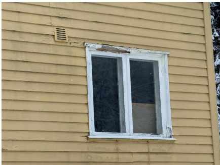
Vindu med råteskader og slitasje
