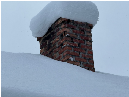
Sprekker i pipe og forvitring av fuger
