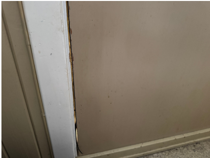
Utett mellom dør og karm
