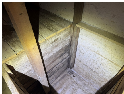
Råteskadet treverk i kjeller som tyder på fukt i grunnmur og kjellergulv
