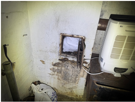
Fukt i nedre del av pipe og snø innenfor sotluke grunnet manglende pipehatt Sprekker i pipe
