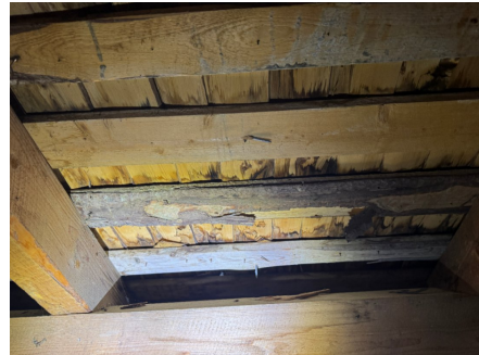
Fuktmerker i undertak
