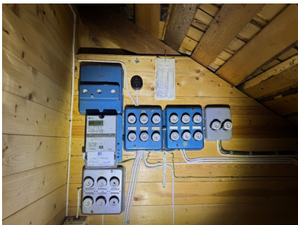
Sikringer på vegg i kott
