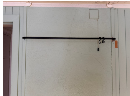
Sprekker i brannmur
