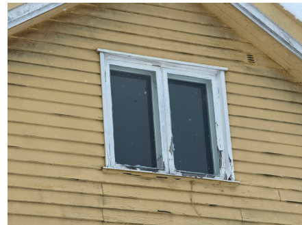
Råteskader i panel og dekkbord rundt vinduer
