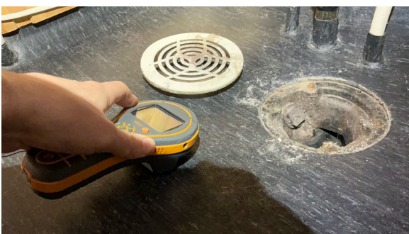
Enkle fuktøk viste normale verdier.
