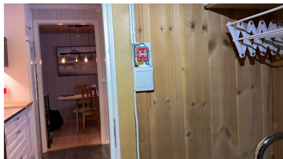
Manglende deksel på bryter vaskerom.
