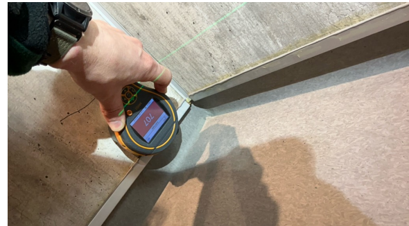
Det er fuktskader på baderomsplater flere steder i dusjzone. Forholdet gis tilstandsgrad 3.
