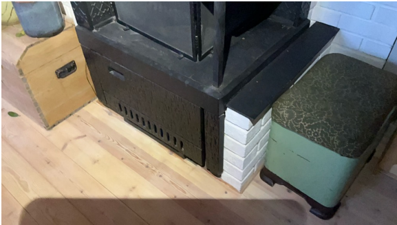
Manglende ubrennbar plate foran ildsted.
