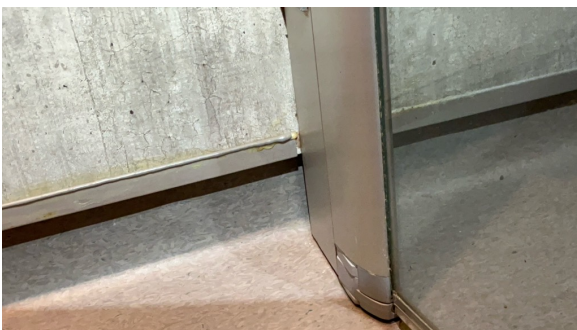
Sokkelskinner under plater er sannsynligvis montert etter veggplatene. Plateskjøter og ender er ikke tilstrekkelig tettet.
