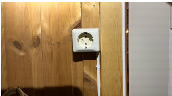
Misfarging/svimerker på stikkontakt til varmtvannsbereder.
