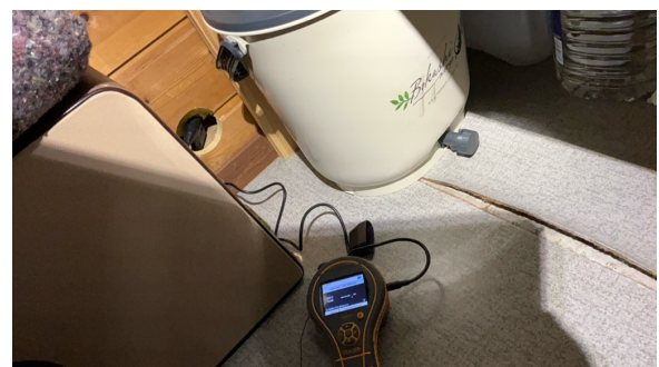
Hulltaking er utført i tilstøtende vegg mot servant/vaskemaskin. Fuktmåling viste tørre verdier.
