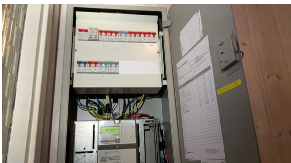
Sikringskap plassert i entrè.
