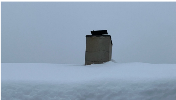
Sprekker og riss på pipe.
