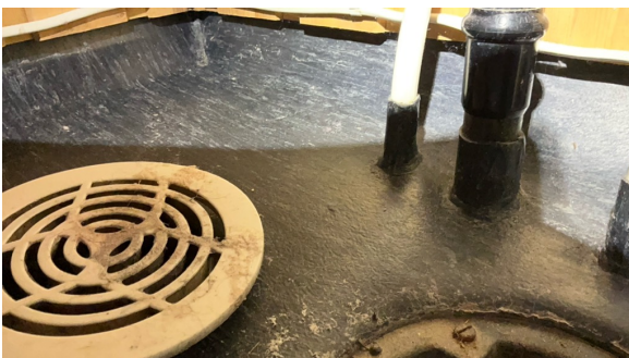
Løst belegg enkelte steder.
