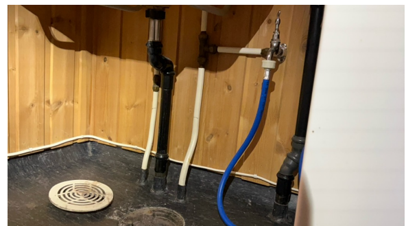
Manglende membran i våtsone vegg bak utslagsvask.
