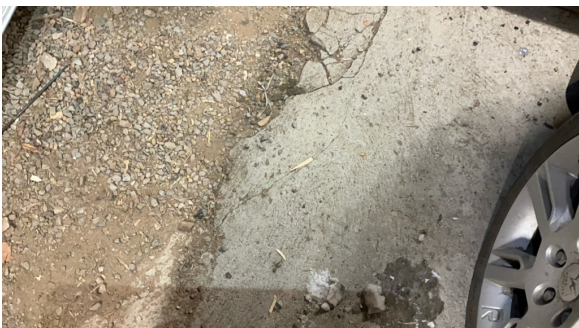
Sprekker på betonggulv i garasje.
