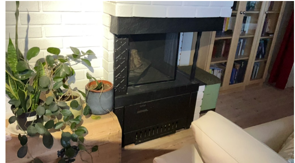
Kombinert vedfyrt og parafinfyrt ovn. Det gjøres oppmerksom på at fyring med fossilt brennstoff er ulovlig.
