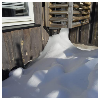
Annet - Kondensvann fra varmepumpe
