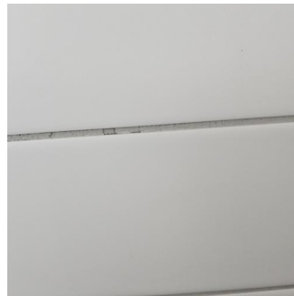
Overflater vegger - Riss i flisfuger i dusjsonen
