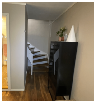
Manglende rekkverk og håndløper innvendig trapp
