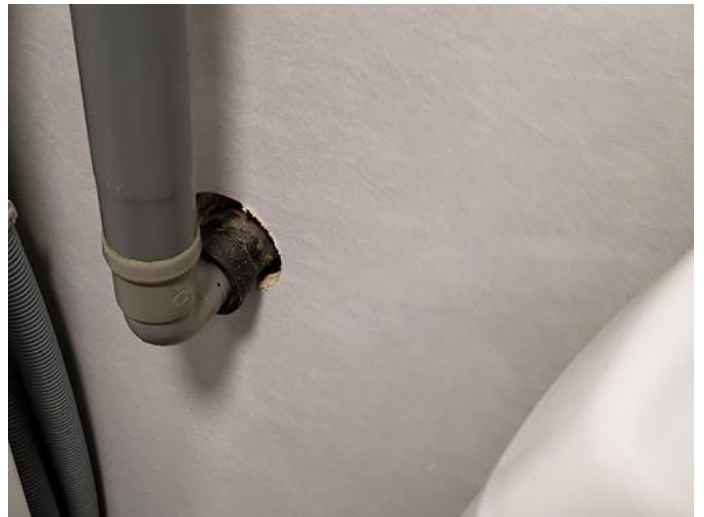
Kommentar - [Rørgjennomføringer bør tettes mot våtromsplater.]
