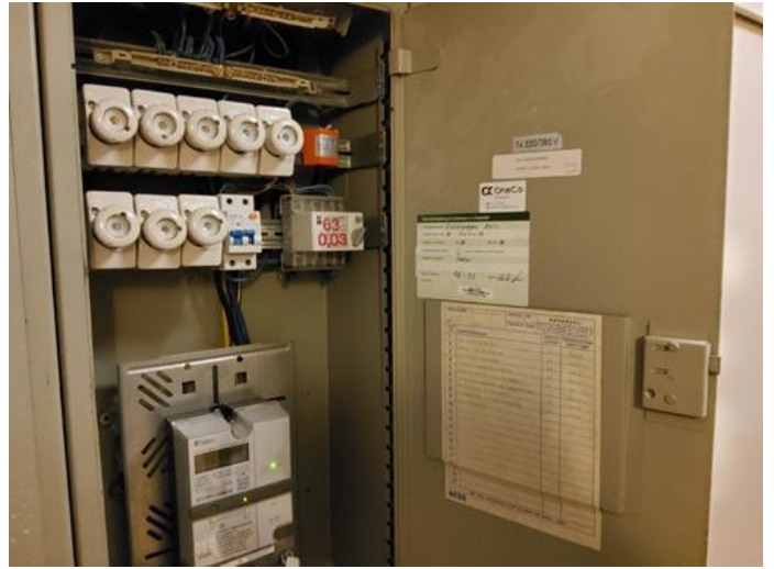
Kommentar - [Sikringskap plassert i felles trappeoppgang.]
