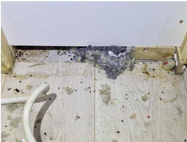
Masse spor, lukt, og byggemateriale under kjøkkeninnredning
