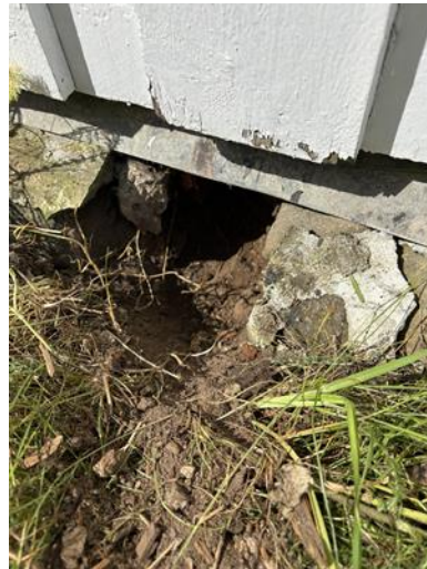
Stort hull i mur som ble støpt igjen
