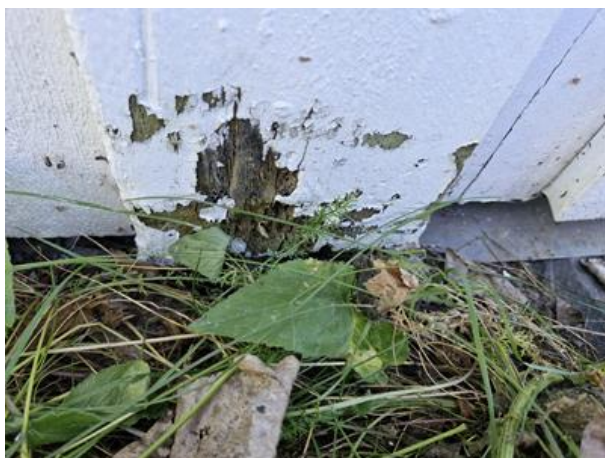
Råteskader gir inntreksmuligheter for mus
