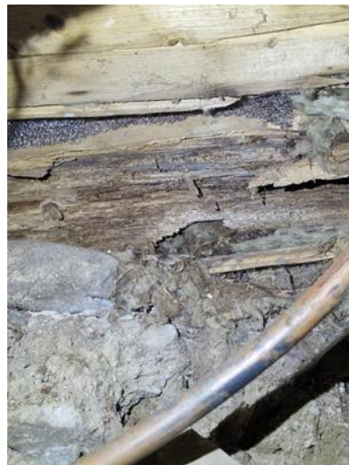
Musegang i råteskadet svill under kjøkkengulv
