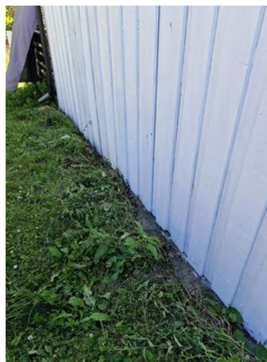
Vegetasjon helt opp til kledning. Dette har forårsaket råte og glipper i panel
