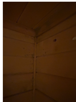
Tegn på fukt i hjørne i badstuen.
