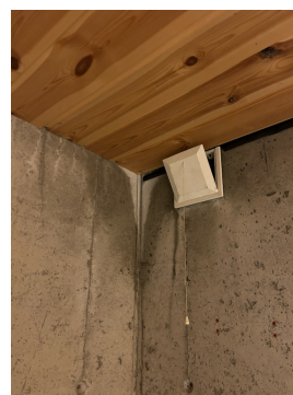
Fukt og rim innvendig på kjellermur.
