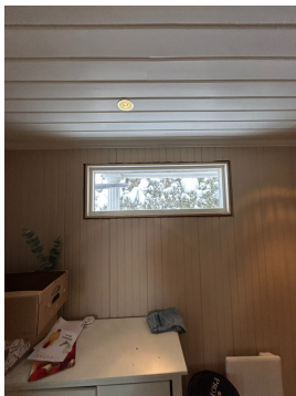
Manglende utføringer og listverk.
