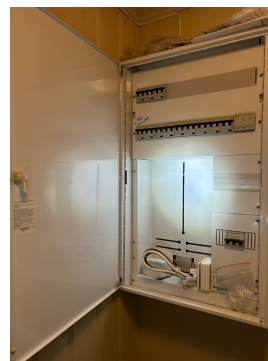
Sikringsskap i utleieleilighet uten kursfortegnelse.
