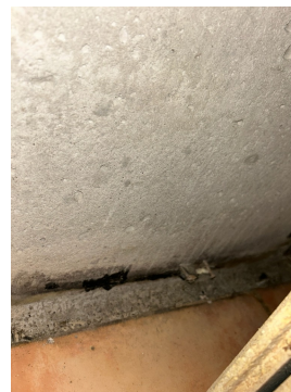
Fuktinntrenging i bunnen langs kjellermur.
