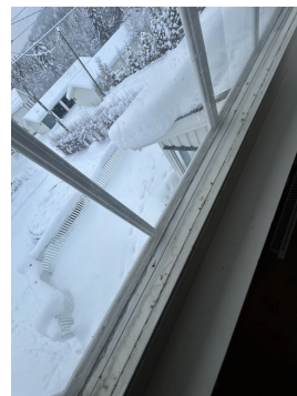
1+1 lags vindu utlevd sin forventede levetid.
