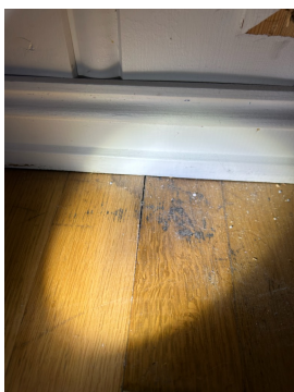
Fuktskjolder på gulv i samme rom.
