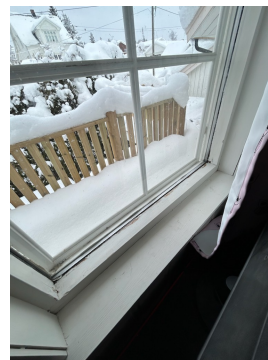
2-lags vindu bærer preg av innvendig kondensering over tid.
