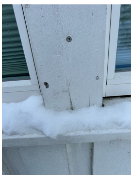
Sprekkdannelser i utvendig omramning.
