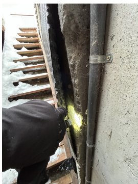
Grunnmursplast mangler avslutningslist.
