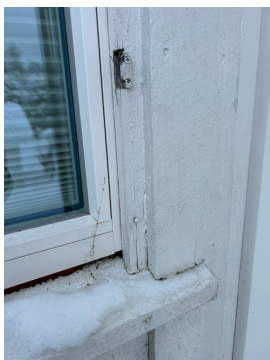
Sprekkdannelser i utvendig omramning.
