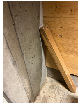
Fukt og rim innvendig på kjellermur.
