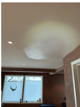
Merke i tak fra utbedring etter vannlekkasje fra bad i 2.etg.
