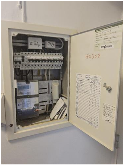
Elektrisk anlegg - [Sikringskap. ]
