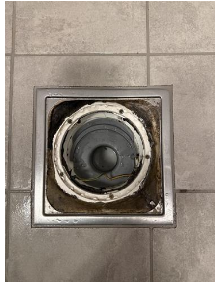
Våtrom - [Sluk på bad.]
